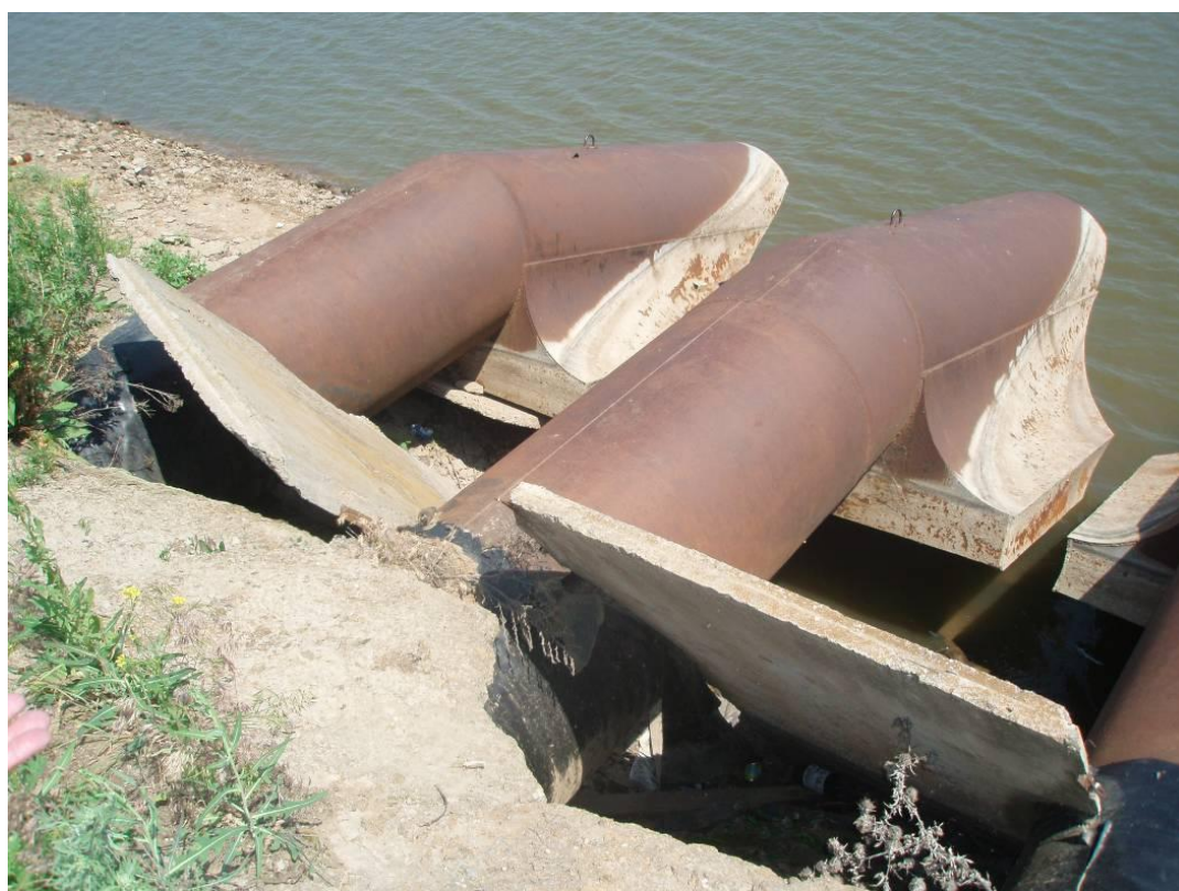
Рисунок 12.21 – Обрушение крепления верхнего откоса возле водосброса
