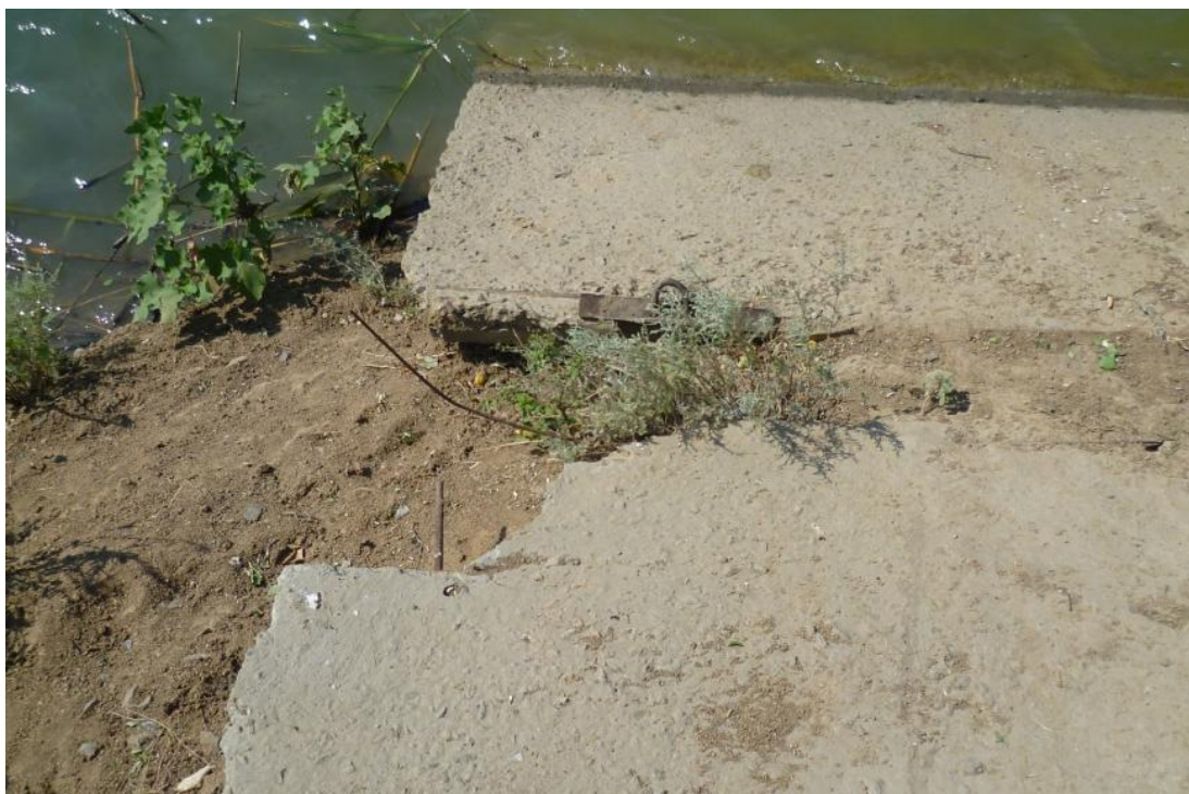
Рисунок 10.13 – Разрушение и сползание плит облицовки на Пролетарском магистральном канале
