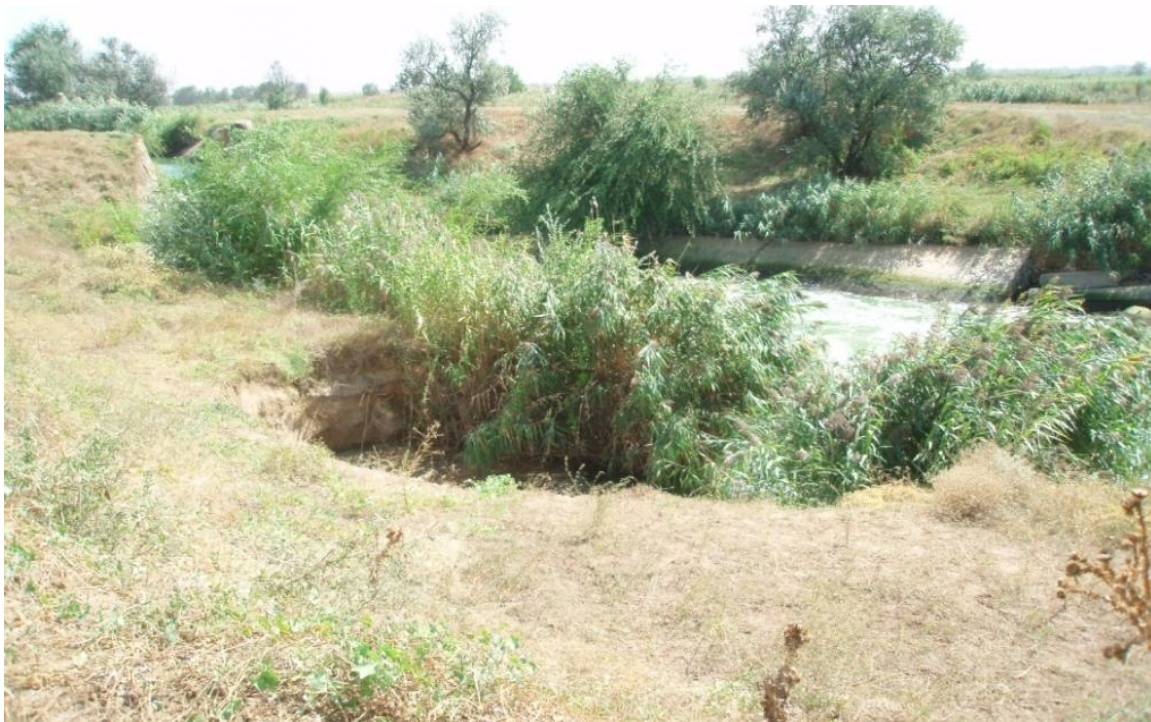
Рисунок 10.11 – Деформации берегов Пролетарского магистрального канала
