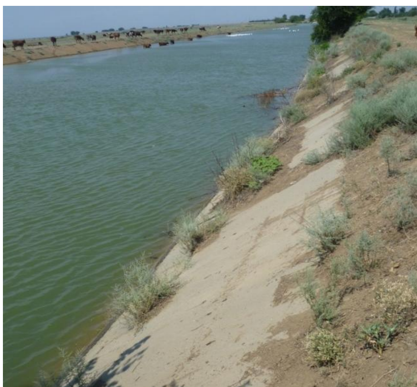
Рисунок 10.14 – Обрастание плит облицовки растительностью на Пролетарском магистральном канале
