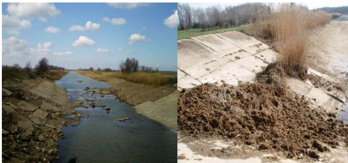
Рисунок 10.10 – Разрушение плит облицовки на Донском магистральном канале
