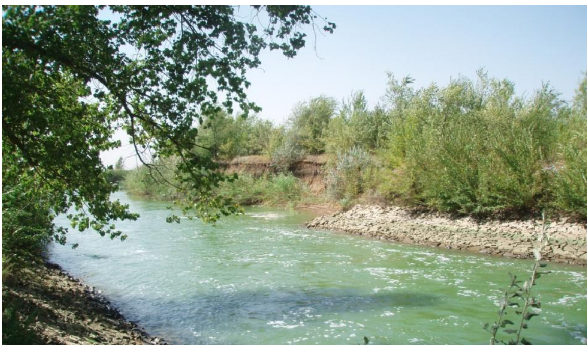
Рисунок 10.12 – Размыв берегов Пролетарского магистрального канала
